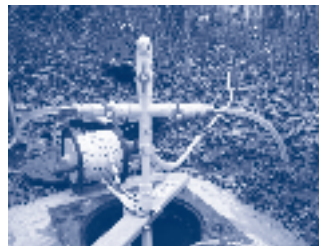
Fragment zestawu do prowadzenia zintegrowanych pompowań testowych (IPT) w otworach badawczych wykonanych na przemysłowym terenie Zakola Łyny w Olsztynie (projekt UE MAGIC)
